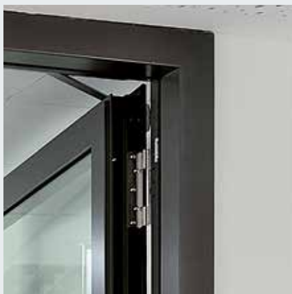
Zárubňa predpripravená pre horný zatvárač dverí
